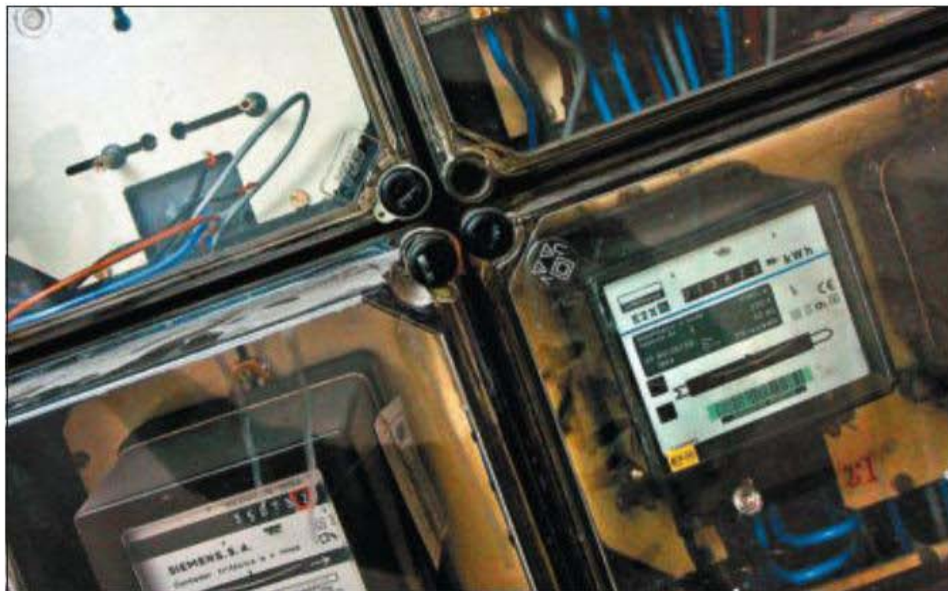
Contadores de consumo de electricidad en una vivienda. / TOLO RAMÓN
